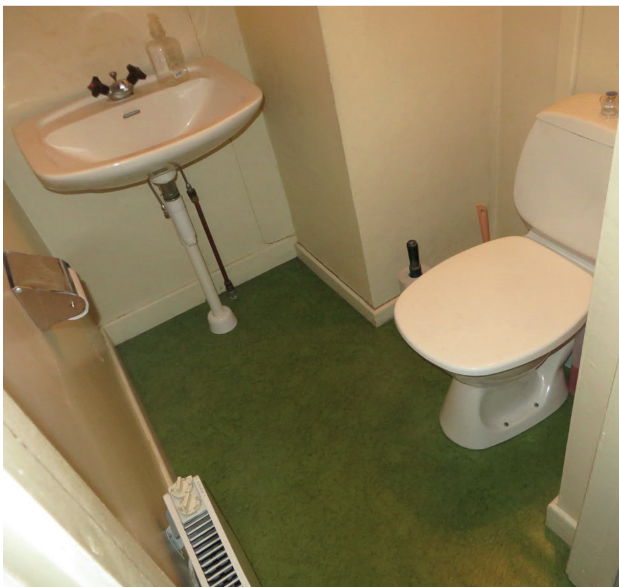
Avloppet från toalettens handfat läckte.
