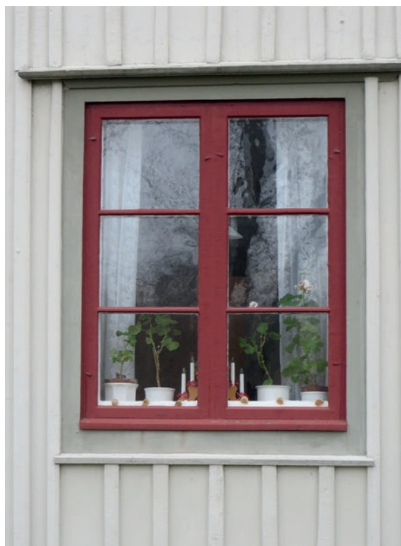
Den östra gavelns nedre vänstra fönster (sett från utsidan) före åtgärd.
