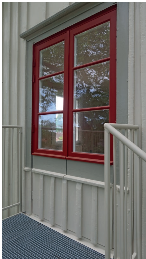
Fönsterdörren har försetts med panel och målats för att se ut som ett fönster.
