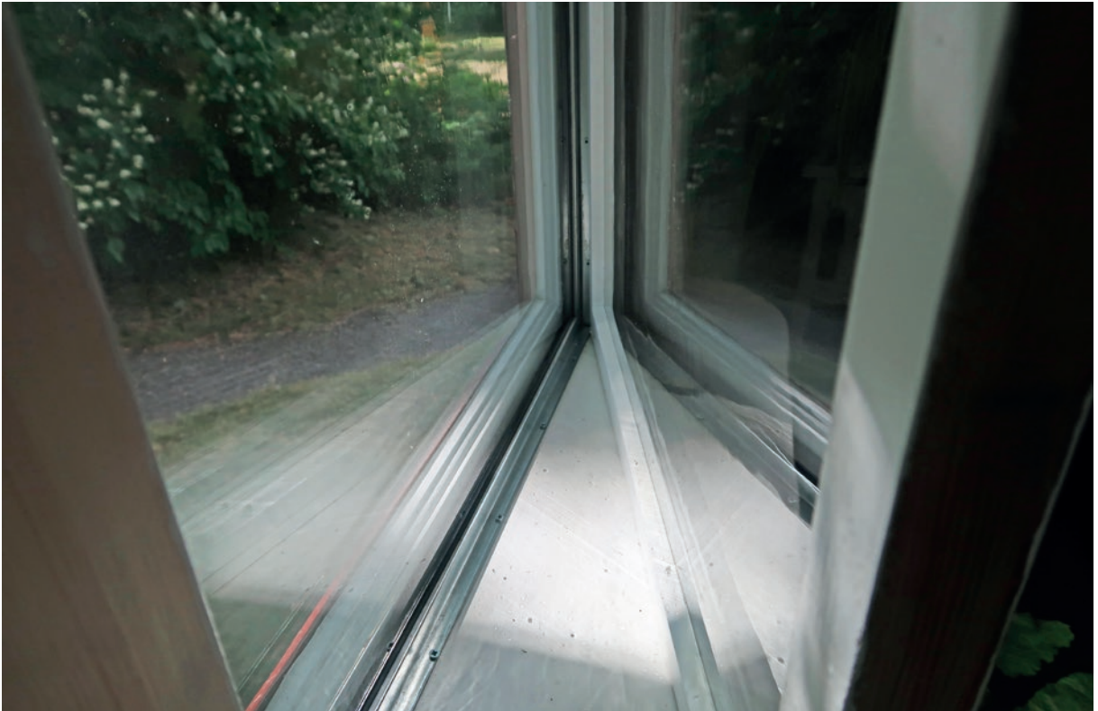
Närbild av brandskyddsglasets infästning. Metallisten som håller brandskyddsglasets på plats är så låg att den döljs bakom bågarna.
